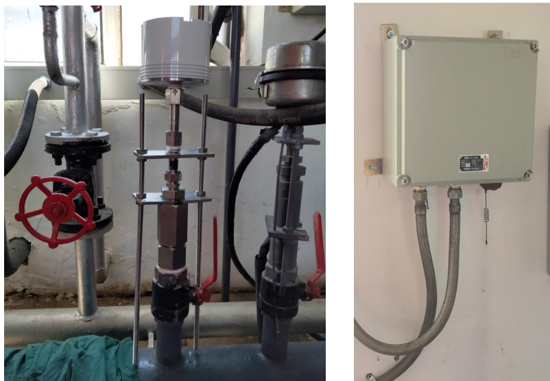
图 3. CST400 电阻探针腐蚀监测仪（左图）及 CST610 无线收发器（安装于右图防爆箱中）在某油田 CO 2 注气驱替输管的安装照片
